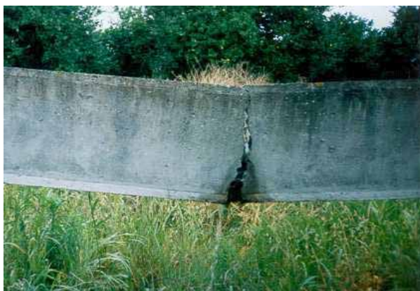
Fotografía 1. Canal de riego con fugas
